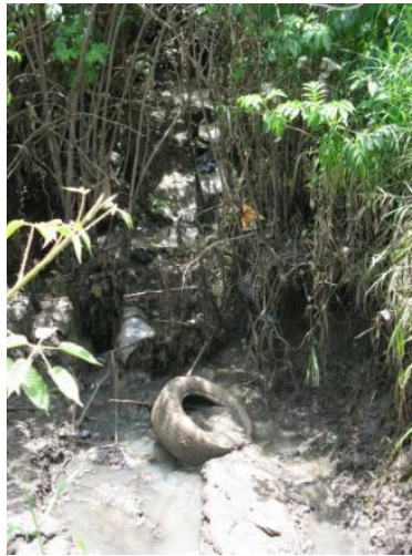
Descarga de aguas residuales sin tratamiento
